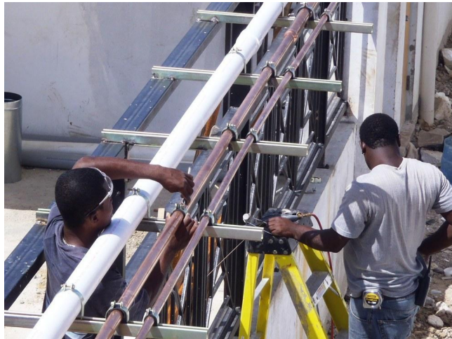
Figura 5a: MGPS instalado à superfície*
